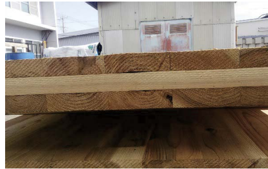
注入後の接着層はく離
