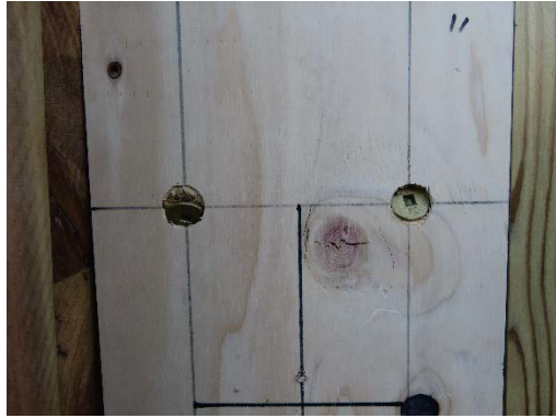
写真 2.3.4-2 タッピングねじ頭部の傾きと合板へのめり込み
