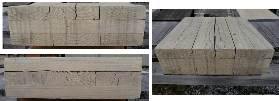
写真 4.2.1-1 ひび割れの状況 (2023年2月24日：暴露開始後約2年4ヶ月経過時)
