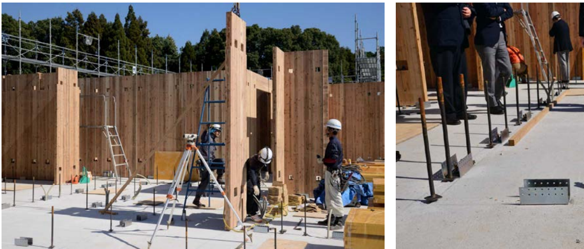
写真6-1 建方状況と基礎コンクリートに配置された接合金物 (2017年10月・写真撮影・提供は特記ある場合を除き全て執筆担当者(新藤))
