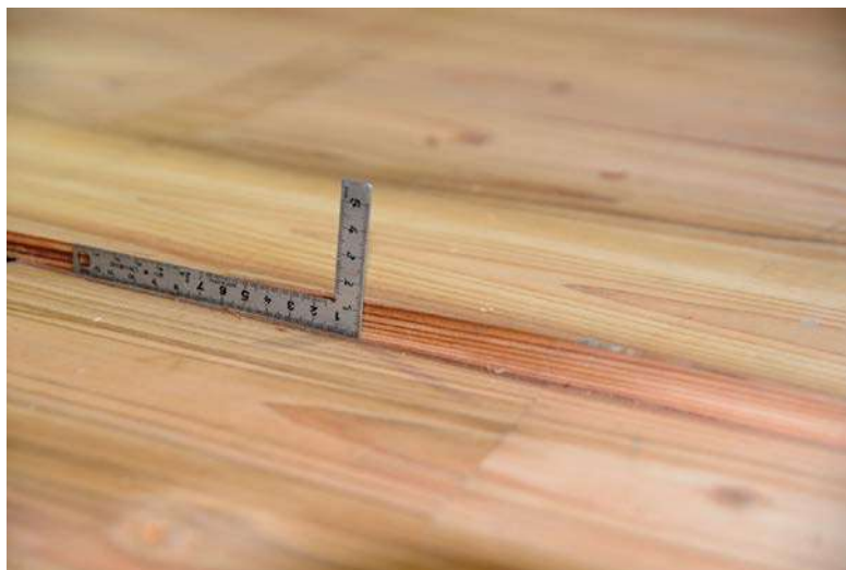
写真2. 2. 1-5 製品注入後のCLT-最大約15mmの浮き (AZN-No. 12)
